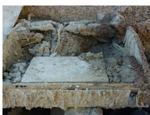
Esempio di vano tecnico standard utilizzata in ambienti molto polverosi
